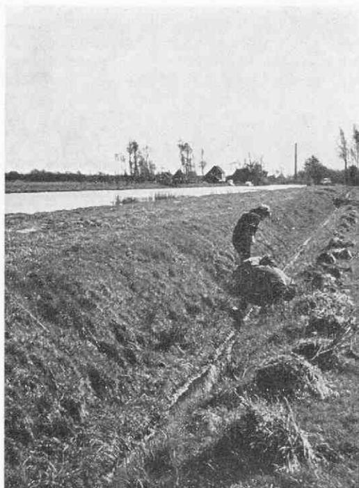
Kwelzone achter een smalle dijk.
