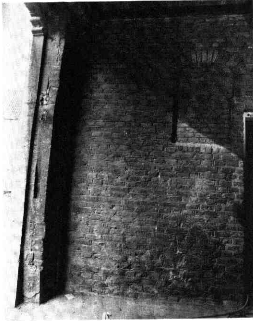
Afb. 109 Springweg 102-102A. Poorthuis. Detail van de noordwand met dichtgemetseld venster en, links, de zijpost van de hardstenen poort met een sleuf voor een sluitbalk.
