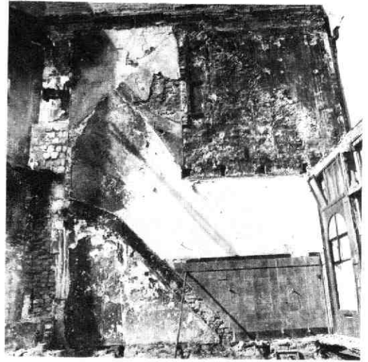
Afb. 35 Biltstraat 57-59. De na de brand vrijgekomen 17e-eeuwse eindgevel in de westmuur van Biltstraat 57.
