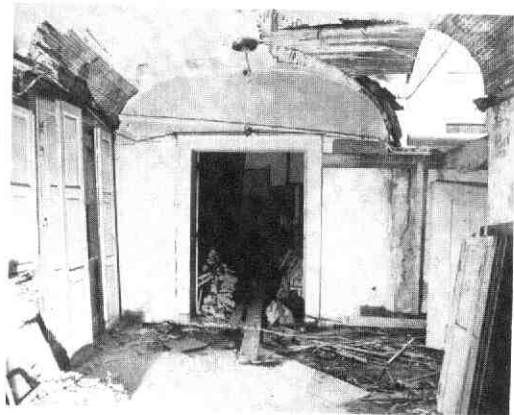
Afb. 22 Achter St Pieter 4. De dwarsvleugel gezien in de richting van de keuken. Links: de tuinzijde. Rechts: de hoofdingang met ingestort gewelf.
