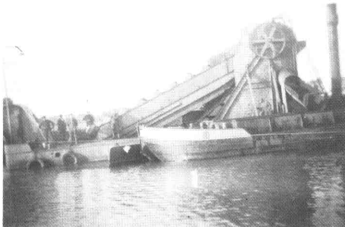
De baggermolen die tussen twee dijken het cunet uitbaggerde, waar later het zandlichaam van de weg in zou komen
