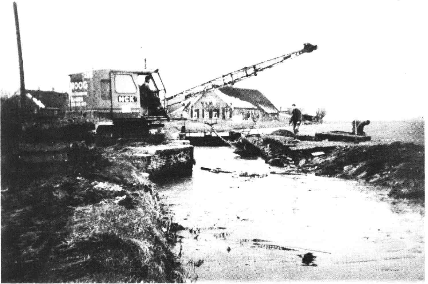
De sloop van de sluis in de jaren vijftig. Met een dragline werden de sluiswanden omvergehaald. Rechts op de kant een sluisdeur. Op de achtergrond in het midden de boerderij van J.J. Vernooij, links de boerderij Zeldenrijk. Foto C. Ekema.
