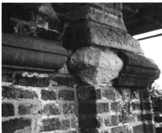
De waterlijst op de tweede geleding. Het donkere gedeelte rechts is nog in goede staat en van zandsteen, daarvoor ziet u een aangetast gedeelte van mergel hetgeen bruut gehakt is. Links een gedeelte van de nieuw aangezette lijst.
