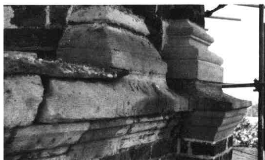
Basement van de vierde geleding. Op de voorgrond een nog niet hersteld gedeelte, daarachter een hersteld gedeelte.
