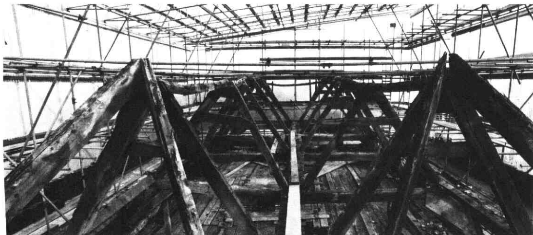
Afb. 18. Kapconstructie vóór de restauratie: twee smalle kapjes naast elkaar, met daartussen een zakgoot (zie afb. 21) rustend op brede jukken (foto Paul van Vliet, 1983).
