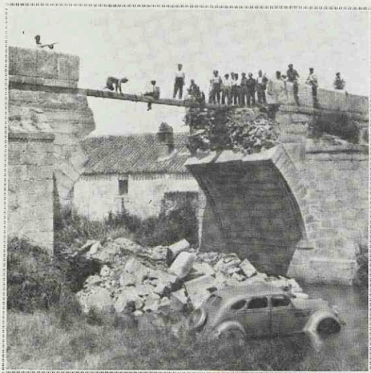
Le pont écroulé de Guadarrama.
