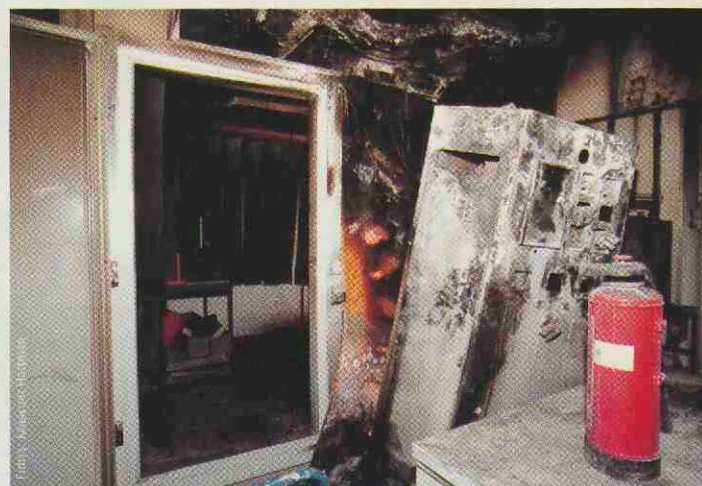
Brandschade in de westvleugel van het Kruidgebouw
