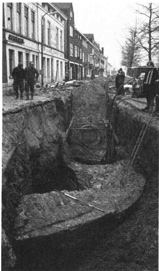
Afb 12. Van Asch van Wijckskade. Wand van de Wolleweverstoren. De bovenste 13 lagen aan de bontkant zijn beklapt met 17e eeuwse stenen.
