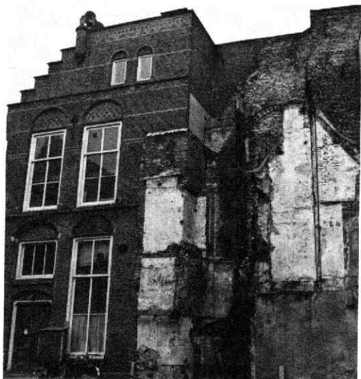
Afb. 19 Minrebroederstraat 2. Restanten van het westelijke raam in de noordmuur van de Minrebroederkerk; gezien naar het noorden.
