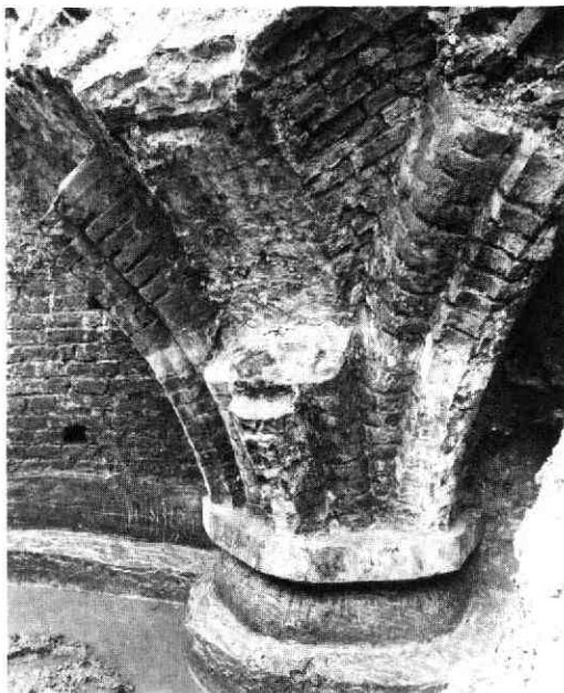
Afb. 102 Vredenburg. Vlaamse toren. Detail van pilaster en gewelfaanzet met ribben in de onderste verdieping, gezien naar het noordwesten. Het afgebroken deel van de middelste rib is geborgen.
