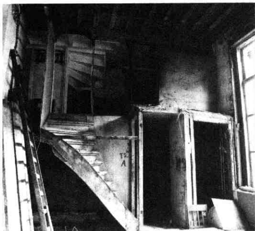
Afb. 70 Haverstraat 6. Gezicht op het insteekgedeelte in de achterhelft van het huis na de verwijdering van de kamerwand.
