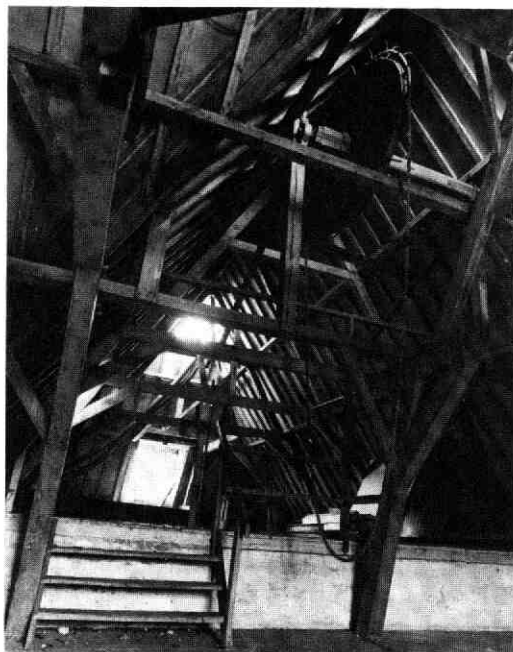
Afb. 106 Koningsweg 1. „Nieuw Amelisweerd”. Overzicht van de hijsinstallatie op de zolder van de rechter vleugel. Op de voorgrond het wiel met een eindloos touw. Van de windas liep het hijstouw gedeeltelijk door de hijsbalk naar de dakkapel op de achtergrond.
