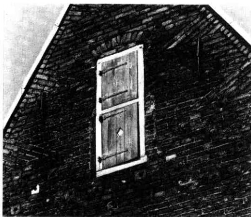
Afb. 67 Hamburgerstraat 9. Detail van de oostelijke topgevel van het schip met diverse invliegstenen van nestholten in het muurwerk.
