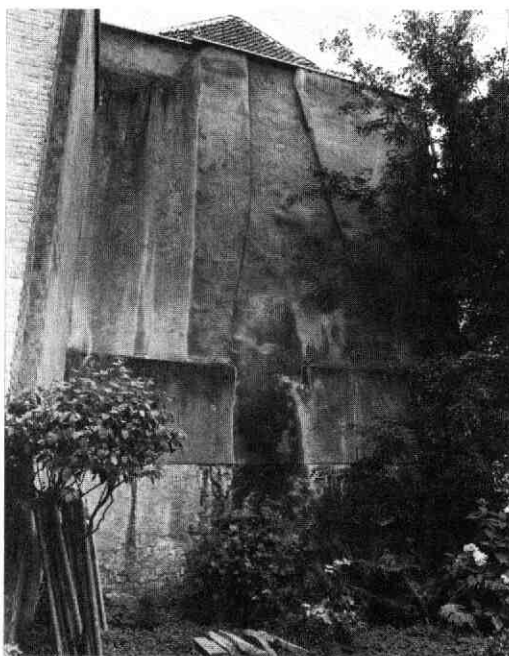
Afb. 115 Kromme Nieuwe Gracht 43. De oostelijke zijmuur van het 18e-eeuwse achterhuis. Deze muur is oorspronkelijk de korte gevel van een verdwenen middeleeuws claustraal huis. Het oude rookkanaal is nog duidelijk herkenbaar.
