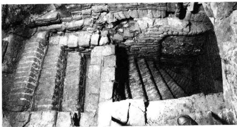
Afb. 14 Abraham Dolesteeg 10. De trap en de ingang van de gang onder de steeg. Door het gewicht van de verdieping op de muurdam tussen de ingangen van 1858 is de korbboog ingedrukt. Het gedeelte rechts van de fundering van de 17e-eeuwse trap-ombouw is als overloop gebruikt voor de beerput van de overkant en was met een gewelf afgesloten.
