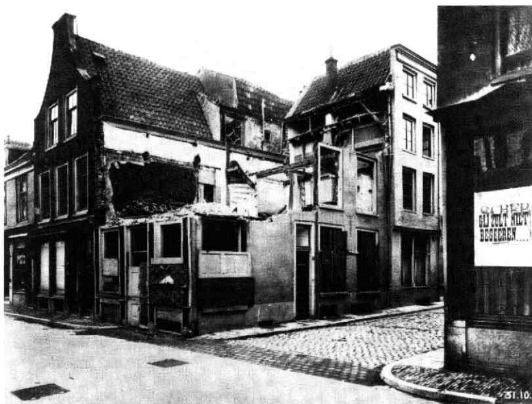
Afb. 182 Springweg 54 en 56. De hoek van de Springweg en de Haverstraat in 1931. Nr. 56 is half gesloopt, zodat de balklagen en de 17e-eeuwse spiltrap te zien zijn. GAU TA Coll. DOW.
