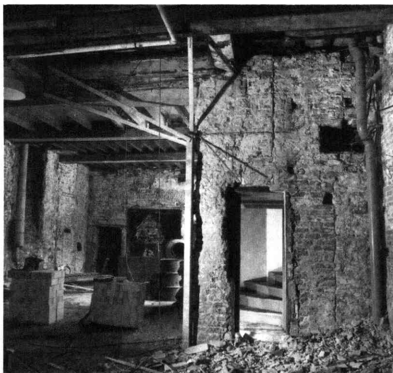
Afb. 65 Jeruzalemstraat 8-10. Begane- grond met doorkijk van de voorvleugel naar de achtervleugel en de spil- trap. Boven de doorgang van de spiltrap is de oor- spronkelijke hoek van een kruisvenster te zien, dat - bij het plaatsen van de trap tijdens bouwfase twee - ongeveer gehal- veerd werd. Achterin: de muurkasten die in de plaats kwamen van de vroegere keuken- schouw. Geheel links: de plaats van de 17e- eeuwse schouw.
