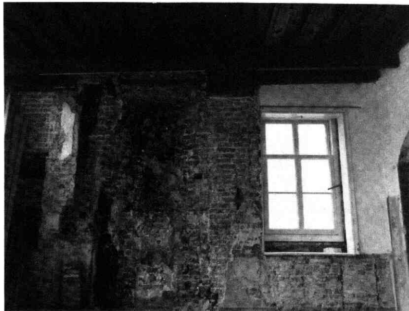
Afb. 56 Jeruzalem- straat 8-10. De noord- westmuur op de verdie- ping ter plaatse van de oorspronkelijke trap- veling. Rechtsboven ver- tonen de kinderbinten een onderbreking. In het midden: sporen van een oorspronkelijke haard.
