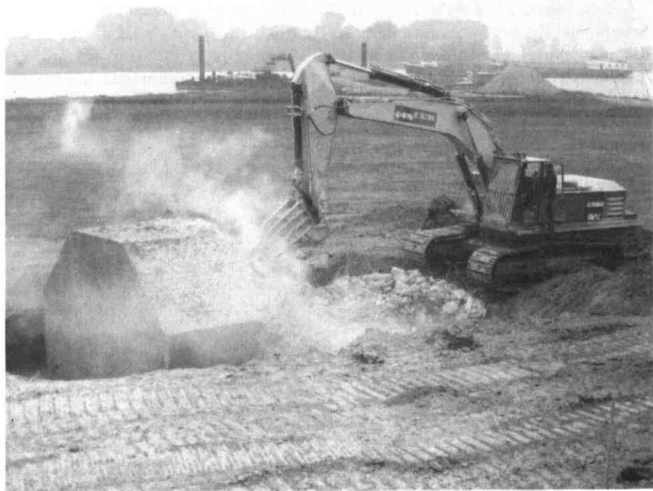
De sloop in 1988 van één van de betonnen kazematten in de uiterwaarden van de Lek nabij de Groeneweg.
